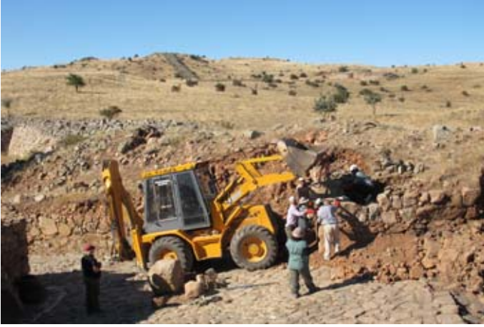
Şekil 78. Kulenin köşesinden zemin döşemesinin üzerine düşen büyük taşlar ancak daha güçlü bir iş makinesinin yardımıyla yerinden kaldırıldı. (11dpcg2412)
